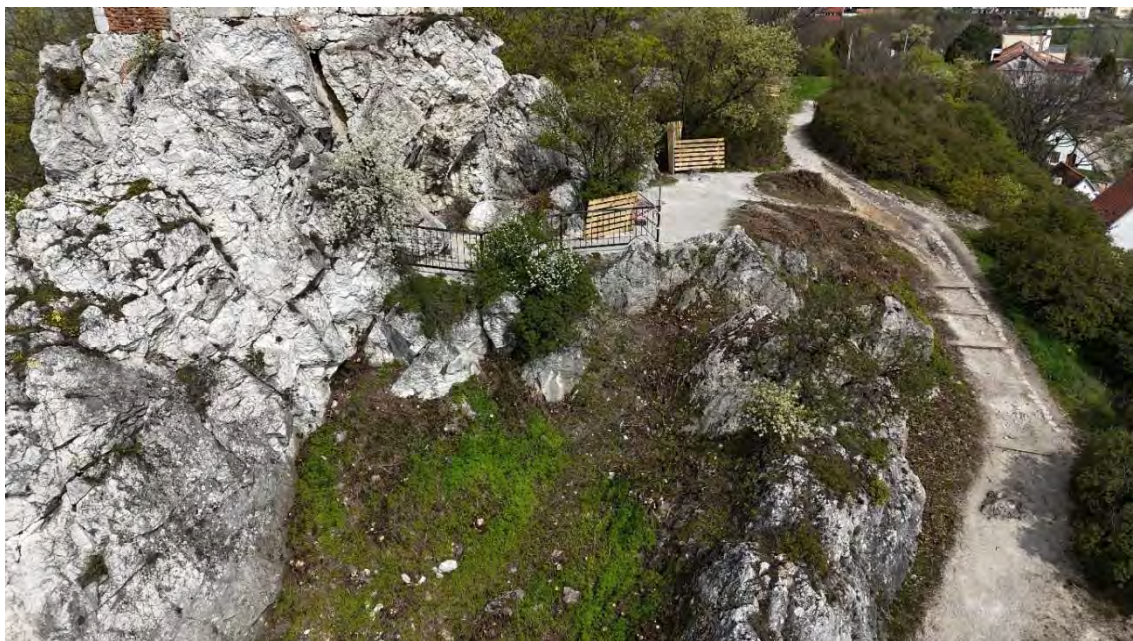
Obrázek 33: pohled na nejvýznamnější partie sektoru VÝCHOD a navazující pochůzí stezky, které budou revitalizovány, na snímku je velmi výrazně zřetelná porucha přímo pod objektem věže Kozího hrádku šířky cca 25 cm
