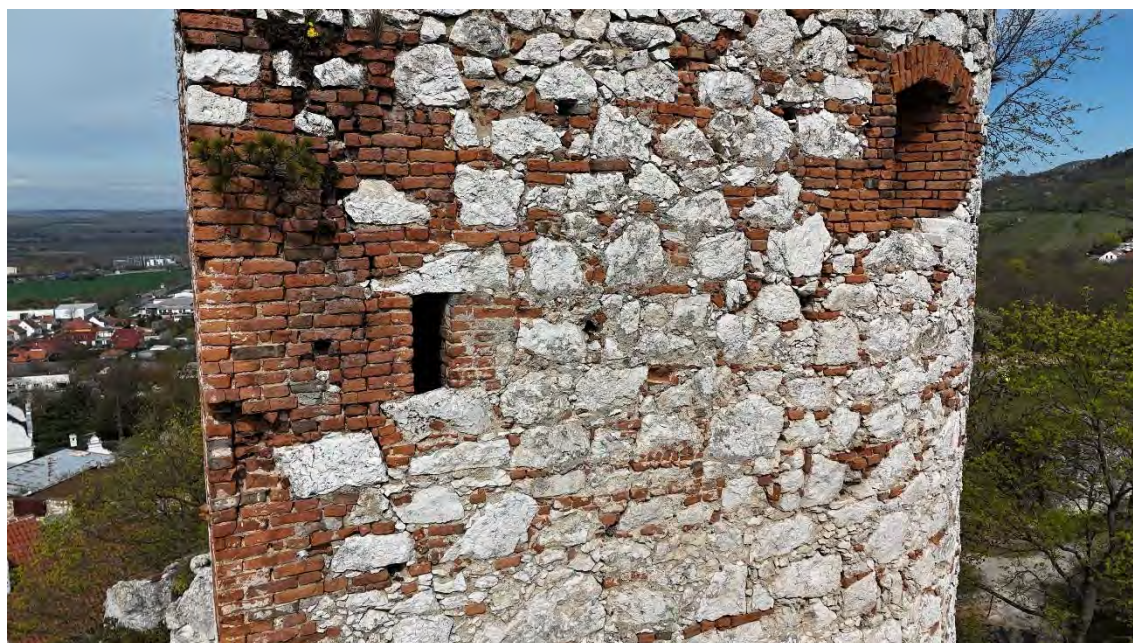
Obrázek 50: ze stavebně technického hlediska se jedná o nehomogenní smíšené zdivo, které je náchylné na změny a smykové poruchy vlivem poruch únosnosti v základové spáře, část zdiva je narušována vegetací
