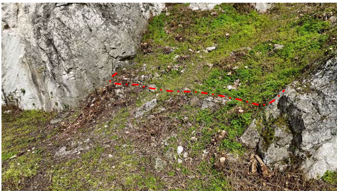
Obrázek 34: stávající hlinitokamenité navážky v sektoru VÝCHOD, vyznačená linie vymezuje určený rozsah zemní prací na odtěžení navážek, pod tuto linie již není doporučeno odtěžovat bez souhlasu geotechnika a zhodnocení skutečných podmínek
