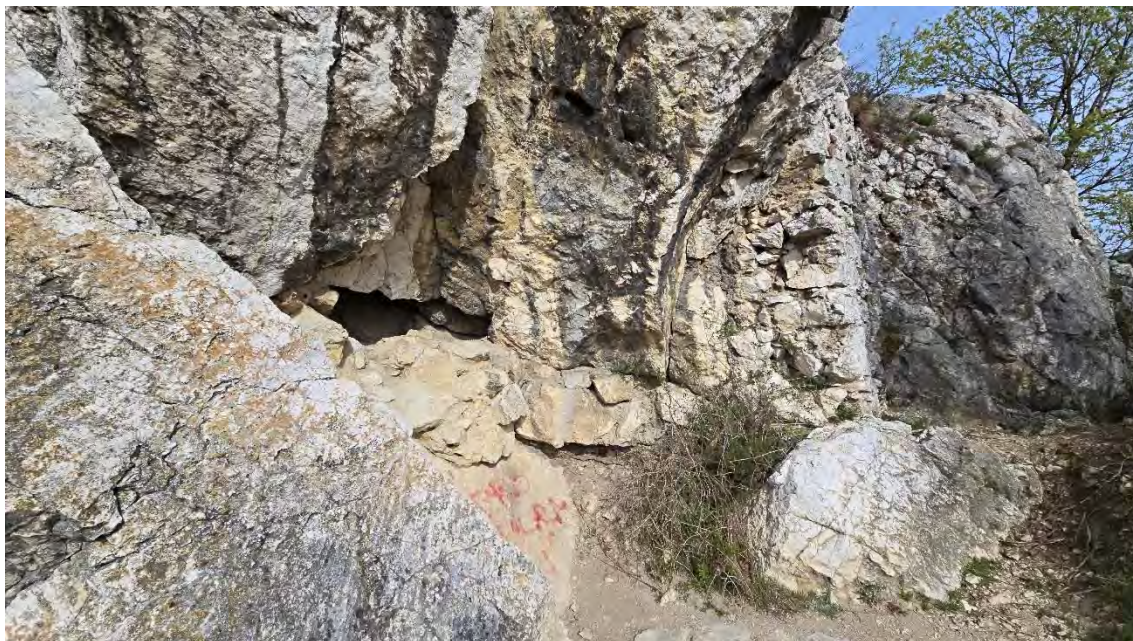
Obrázek 41: spodní partie blokové struktury východní stěny sektoru VĚŽ, zbytky silně narušeného zdiva v centrální části snímku s navazující vyzdívkou, která je patrná na vzrostlou vegetaci, napravo od středu snímku
