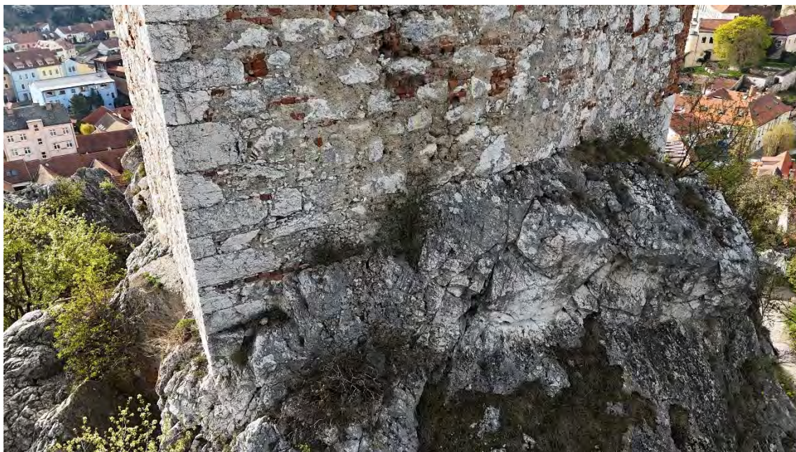
Obrázek 11: detail horní lokace masivu sektoru SEVER s výraznými poruchami masivu a pohled na celkovou stavbu horní rizikové partie masivu
