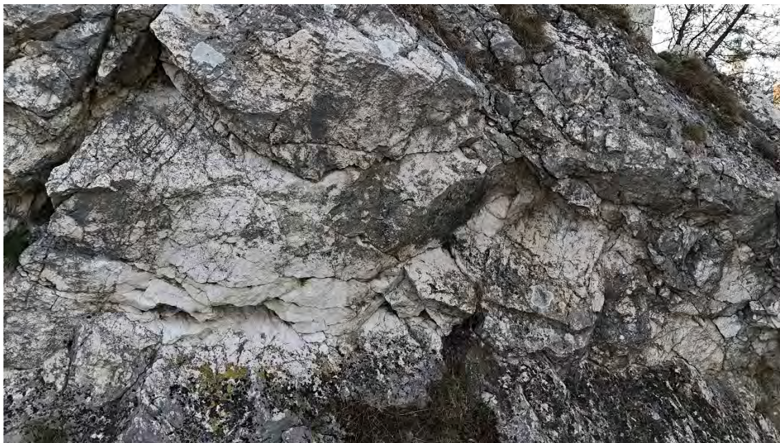
Obrázek 14: detail poruchové horní partie masivu s otevřeným systémem masivu
