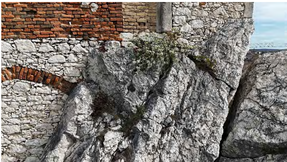
Obrázek 22: pravostranná část jižní stěny věže založené na masivu, možné sledovat i mírně rozvinutý puklinový systém, na pravé straně strukturně oddělený blok sektoru VÝCHOD
